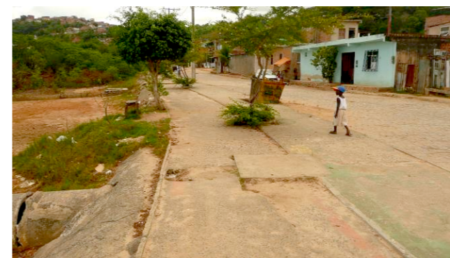
A via existente apresenta desgaste na sua estrutura.
