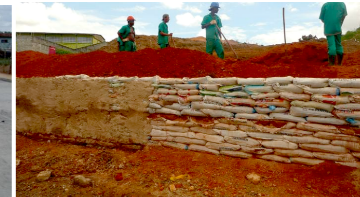
Ausência de geotêxteis na montagem do muro de contenção.
