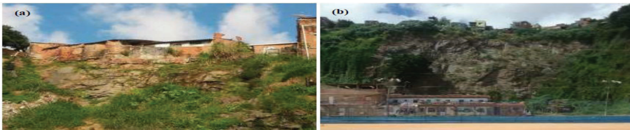
Fig. 7.19: (a) Ocupação assentada diretamente sobre talude de pedreira abandonada, exibindo rocha fraturada. 29-Vila Picasso (556151mE/8571126mN). (b) Panorama da antiga pedreira em Vila Picasso (29), ilustrando exposição do embasamento cristalino fraturado e ocupação no entorno.
