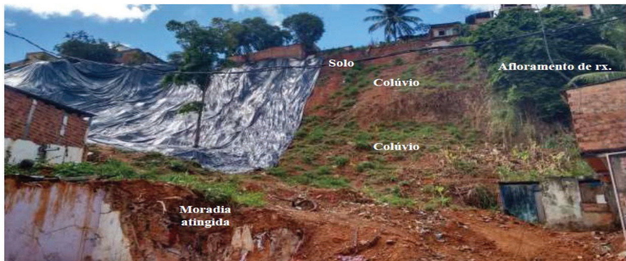
Fig. 7.18 Cicatriz de deslizamento ocorrido em 2015 na rua Coronel Pedro Ferrão (22), ilustrando afloramento do embasamento cristalino, material remobilizado pelo deslizamento e moradia atingida.
