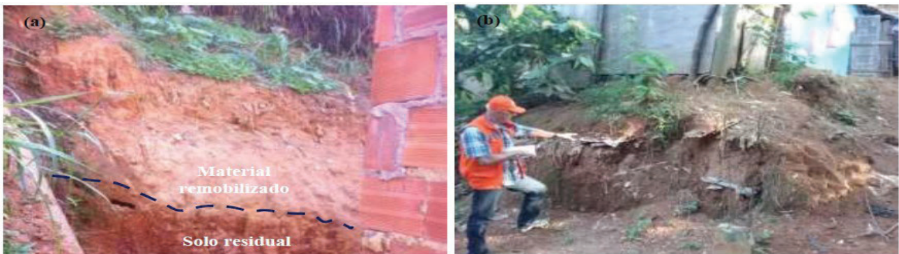
Fig. 7.13: (a) Material remobilizado sobre manto de alteração na meia encosta, 26-São Cipriano (564246mE/8572194mN); (b) Corte no talude evidenciando aterro composto por solo, entulho e lixo, 27Três Manguieiras (563436mE/8571116mN).
