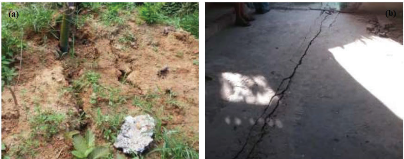
Fig. 7.17: (a) Trinca na encosta, evidenciando carácter expansivo do solo, 25-Sabiá; (b) Trinca em moradia, dano provocado pelo movimento do solo expansivo, Subúrbio ferroviário.
