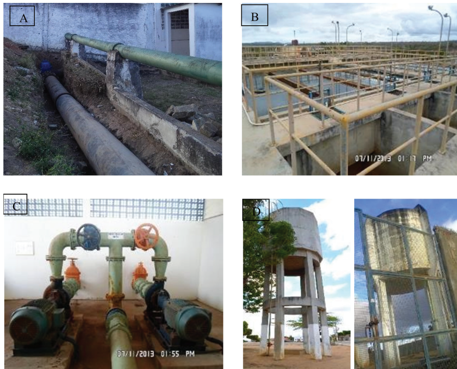
Fig. 9.1 – Sistema Integrado de Abastecimento de Água de Poções e Bom Jesus da Serra: Adutora (A), ETA (B), Estação Elevatória (C) e Reservatórios Elevados (D) . Fonte: PMSB de Poções – BA, 2015.
