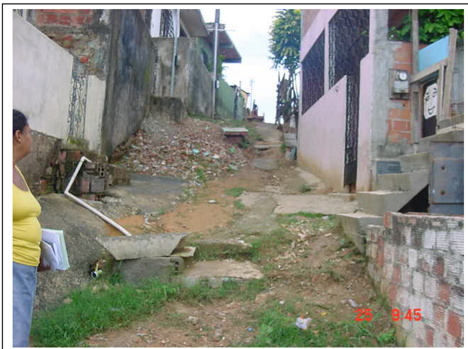
Foto 4 - Pavimentação e drenagem improvisados pela comunidade – Rua dos Unidos - Alto do Bom Viver
