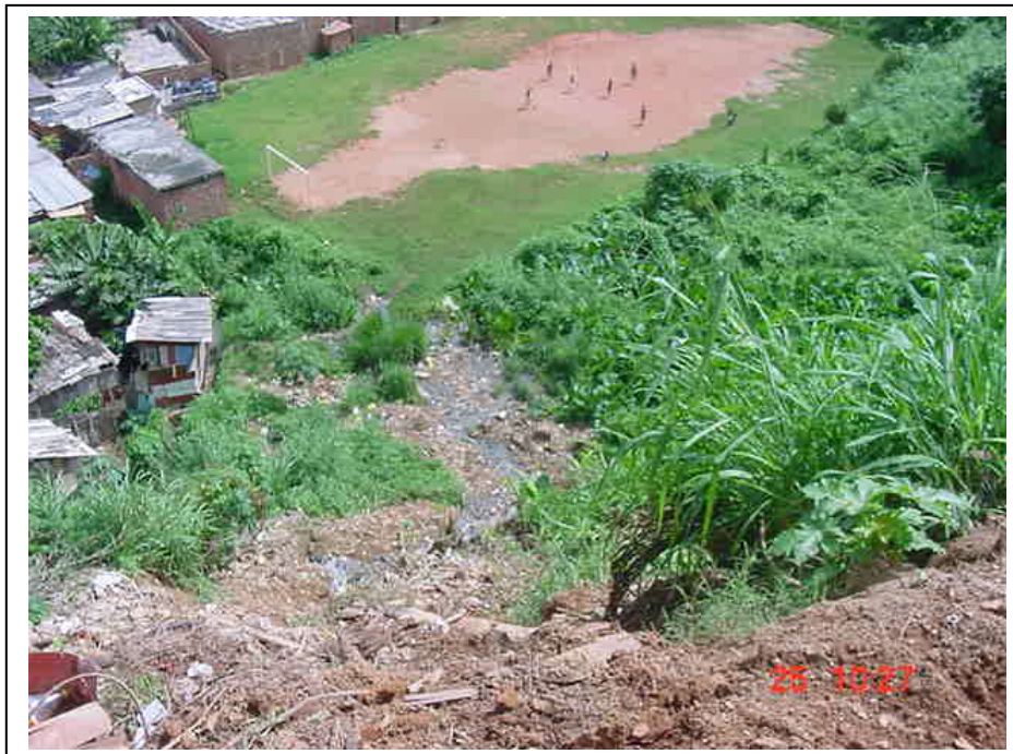
Foto 14 - Esgotos a céu aberto correndo na encosta , onde também pode-se perceber o descarte indiscriminado de resíduos sólidos – Encosta vizinha à Rua dos Unidos - Alto do Bom Viver
